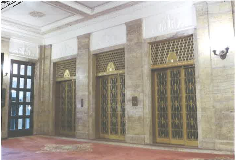
二重ブレーキが未設置の衆院本館のエレベーター
